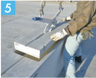
インバートコンクリートの打設作業後、パッキンを貼り専用吊金具にて頂版の据付
